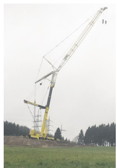
Der Baukran steht still, denn ohne Straße kommt kein Material auf die Baustelle.
